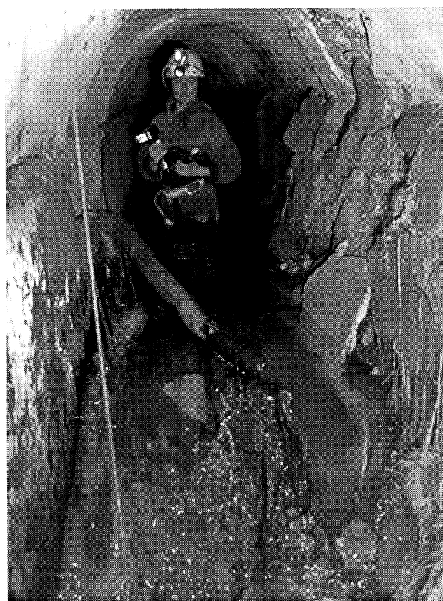
Trevignano - ostruzione nell'acquedotto Traiano (Foto F. Zaccheo)
